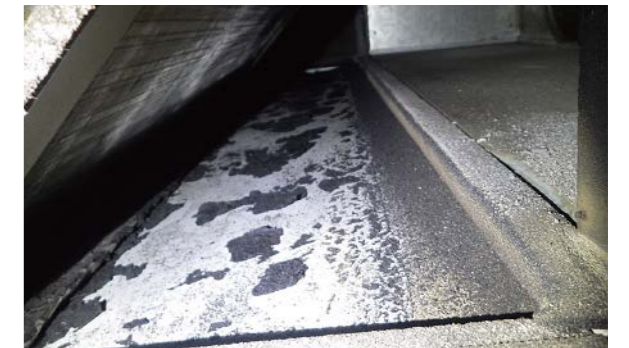
空調機内部に粉体が蓄積
